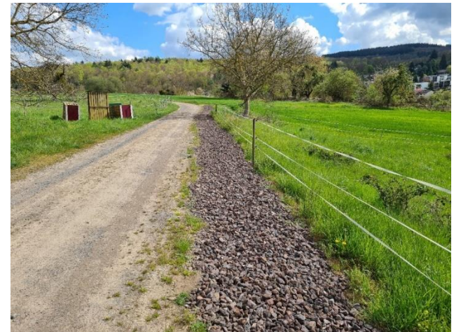
Straßenbegleitende Rigolen in Oberbieber, Quelle: BCE
